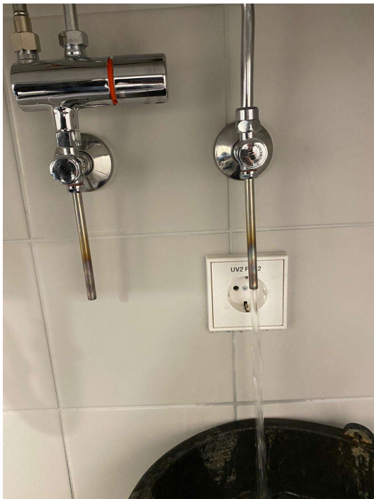
Abbildung 5: Eckventile mit Probenahmearmaturen vor der Verbrühschutzeinrichtung. Hier jedoch ungeeignet angebracht aufgrund der unmittelbaren Nähe zur Steckdose
